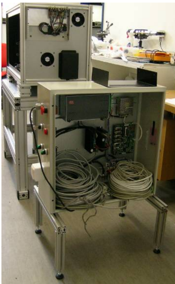
62. ábra A kapcsolószekrény a lábazaton a berendezés mögött. Ez a kép a telepítés előtt készült, látszanak a hosszú feltekert vezetékek melyekre a nagytávolságok miatt volt szükség.
